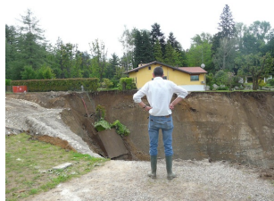
5 – La casa di Somma Lombardo sta crollando – 12/6/2012
